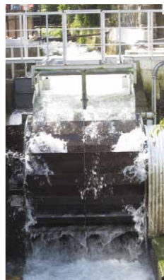
山梨県都留市の小水力発電施設
