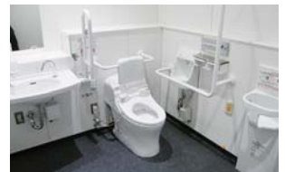
多目的トイレ
