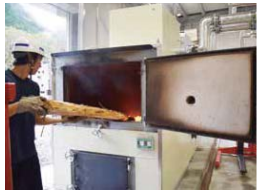
湯谷温泉の薪ボイラー
